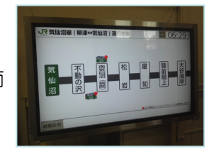
駅（停留所）に設置されたバス・ロケーションシステム
